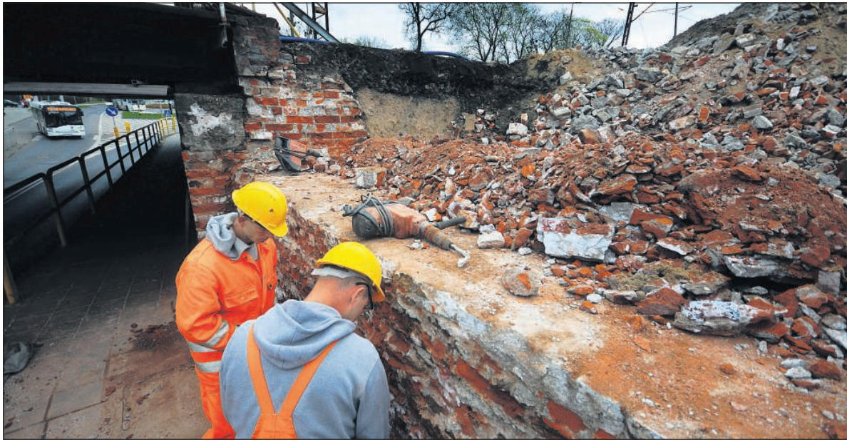
W najbliższy weekend planowane jest zamknięcie wiaduku na placu Armii Krajowej. Na zdjęciu prace prowadzą panowie Kamil i Piotr FOT.: GRZEGORZ OLKOWSKI
