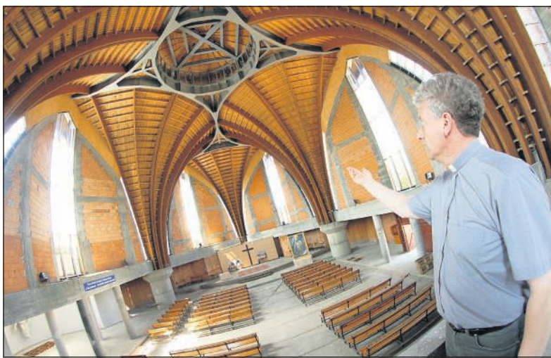
Budowa kościoła jest na etapie wznoszenia ścian, wkrótce zamontowane zostaną okna i drzwi - informuje ks. Ryszard Domin FOT.: SŁAWOMIR KOWALSKI
